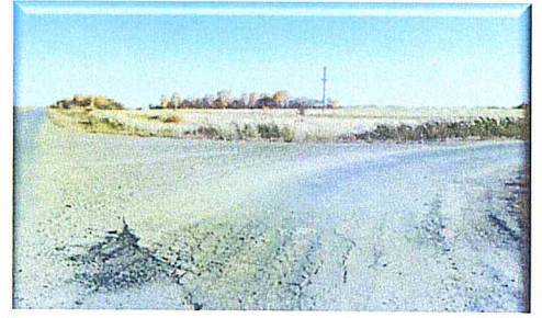
Дефекты дорожного полотна автомобильной дороги Шербакуль-Солнцево-Красноярка
